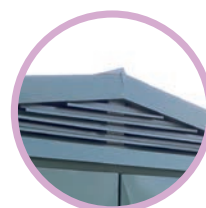
Aération avec des Louvres
